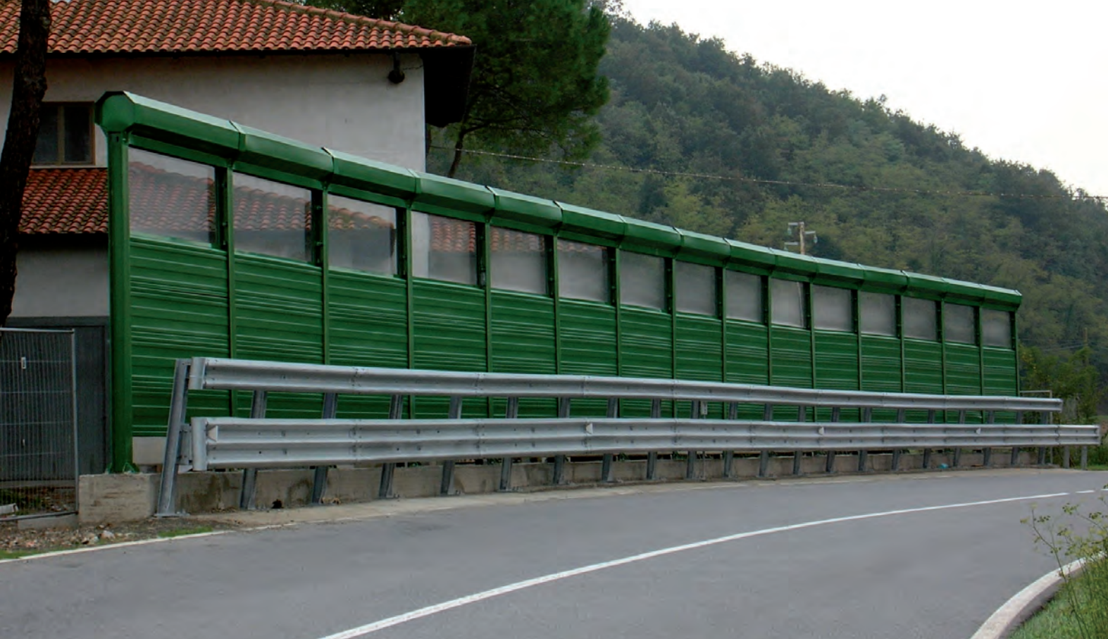
Barriera acustica in alluminio verniciato e barriera H2 bordo ponte. Provincia di Livorno. Aluminium noise protection barrier and H2 class side bridge safety barrier. Livorno - Italy.
