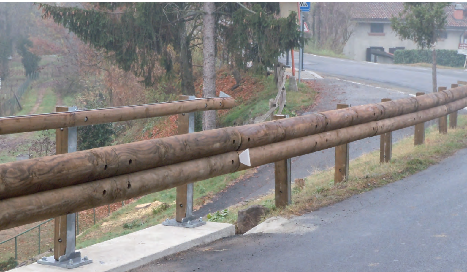
Barriere in classe H2 bordo ponte e barriera H2 bordo laterale in legno-acciaio. SP 100 della Val Curone. H2 class side bridge safety barrier and wood-steel H2 class side edge barrier. Provincial Road 100 Val Curone - Italy.
