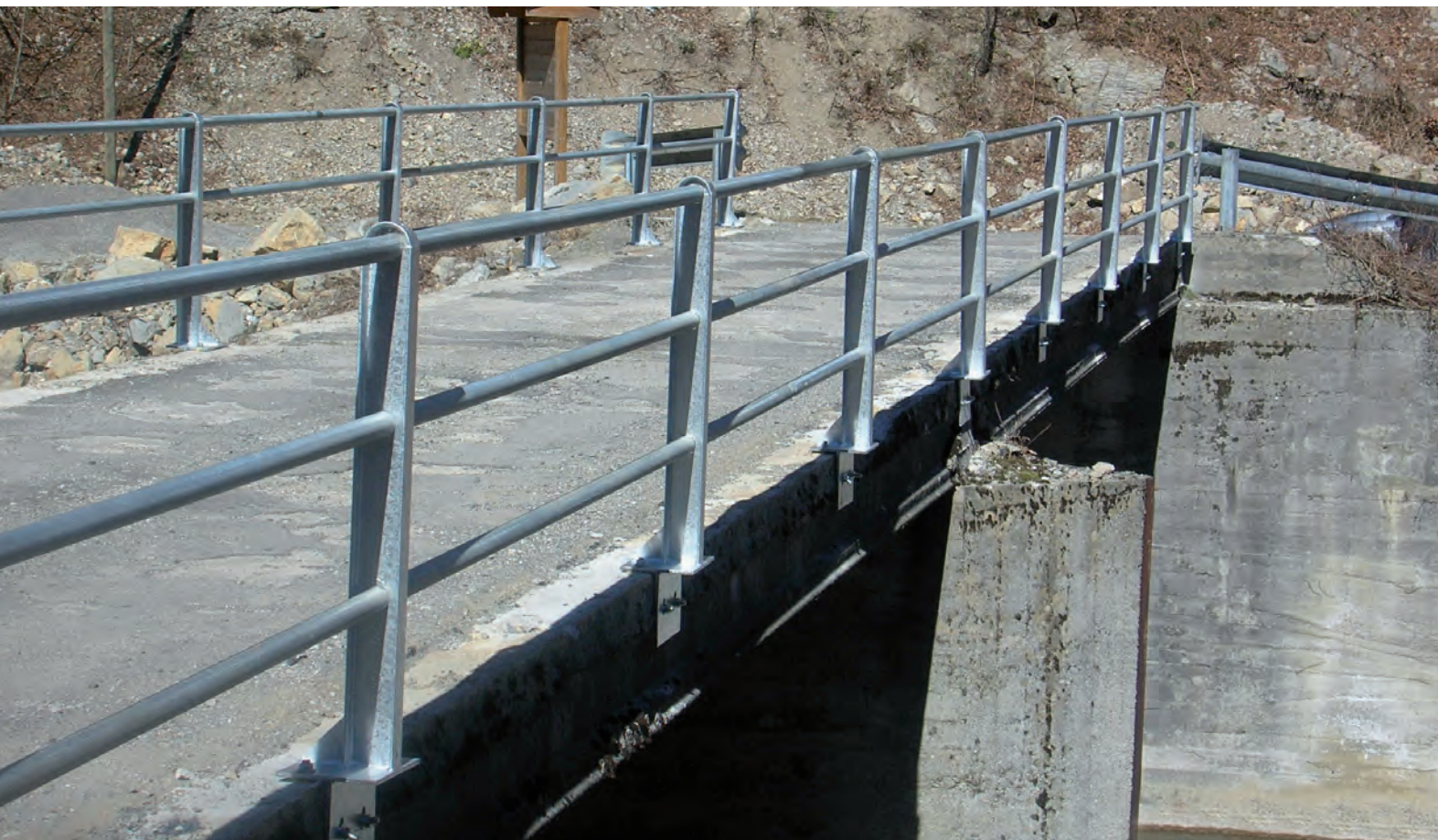
Ringhiera parapetto a tre tubi. Comune di Carrega Ligure (AL). Three tubes safety parapet railing. Carrega Ligure (AL) - Italy.
