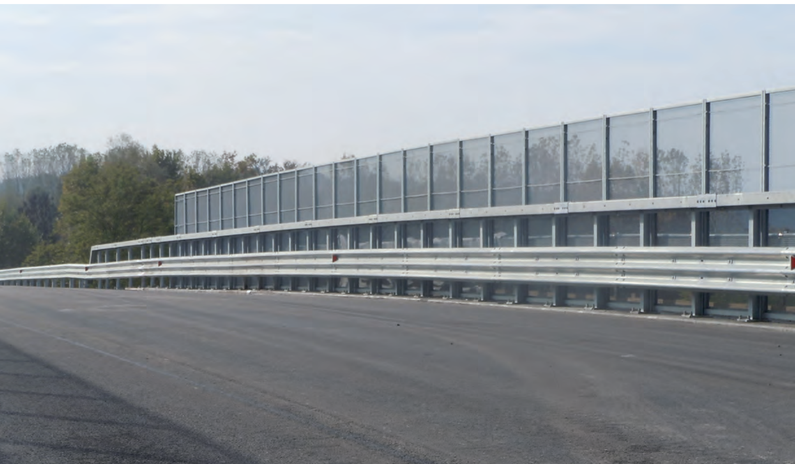
Barriera in classe H4 bordo ponte e pannelli di rete. Svincolo di Albiano.
